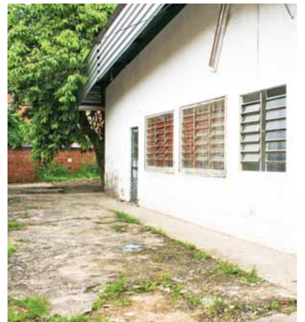
Entrada da creche e, ao fundo, o muro que separa o valão: espaço precisa de reforma
